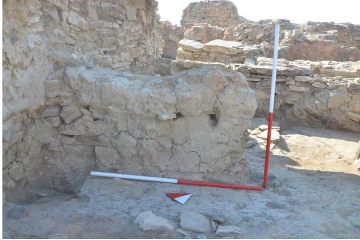
Fot 4. V/D evresi duvar sıvası (yanmamış) örneği
